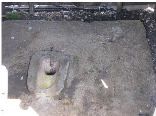
<沈殿槽式トイレ>
